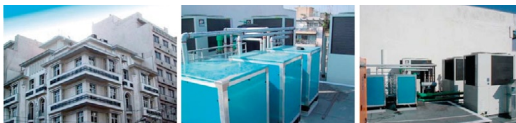
Rys. 12. Instalacja GHP AISIN w hotelu w Atenach. Układ GHP AWS 168 kW.
